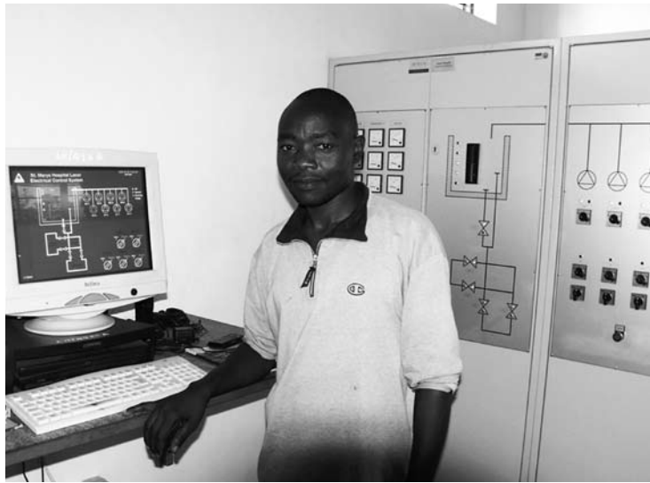
Santo Uma dans la salle de contrôle des installations électriques et hydrauliques
